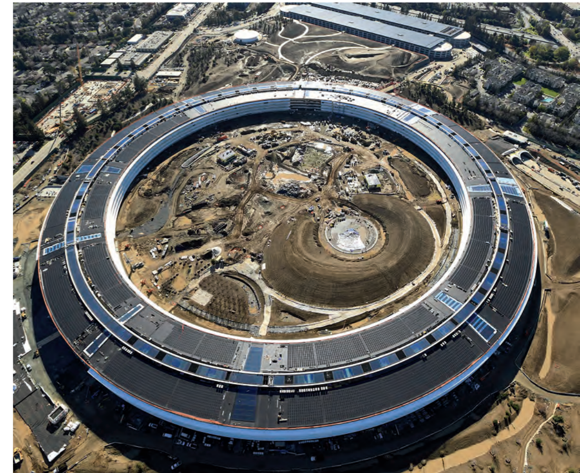
En la página anterior: secciones y fotografía del proyecto en donde se visualiza el acceso vehicular, la relación con la calle y los subsuelos de cochera. En esta página: fotografía aérea de la obra en proceso. Fotografías gentileza Foster + Partners.
